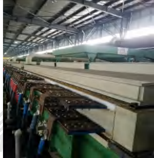
酸洗线中性盐槽
