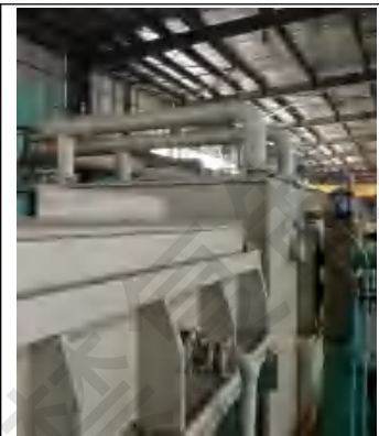
酸洗线混酸清洗槽
