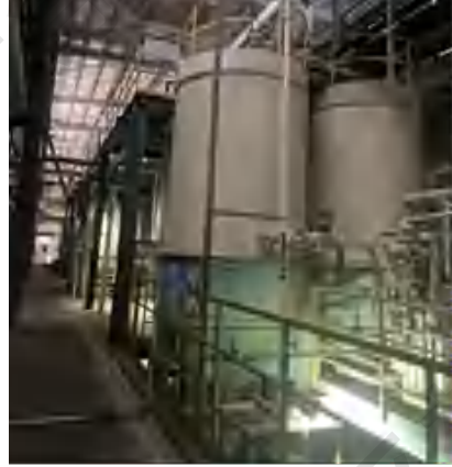
混酸酸洗段罐区
