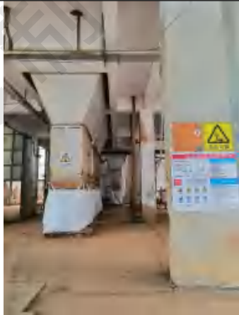
废水站卸泥区
