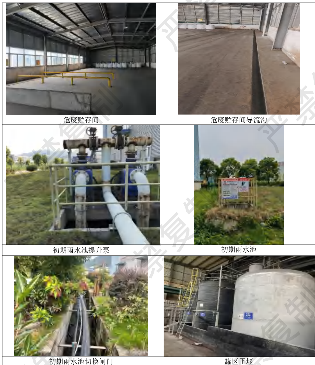
图 6.1-1 现有工程废水污染事故预防措施图片
