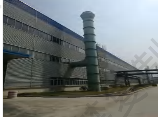
冷轧机组排气筒
