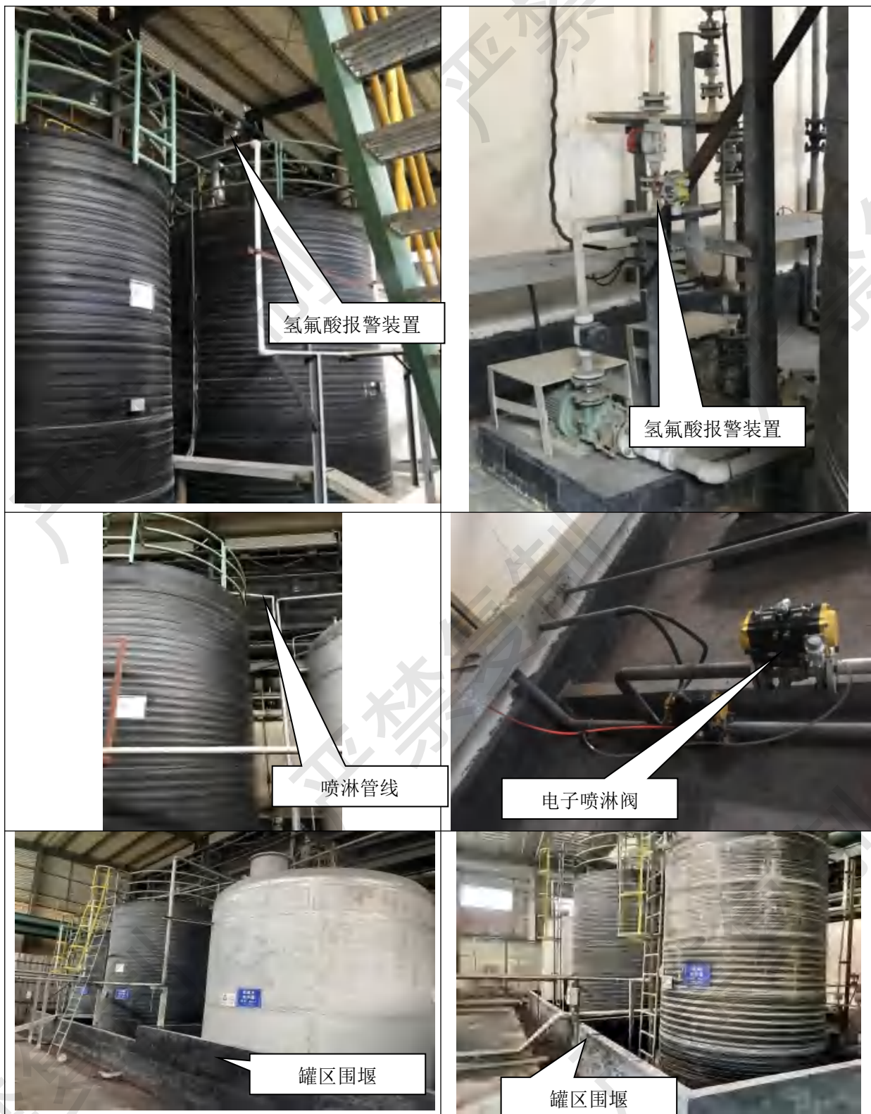
图 6.1-2 现有罐区防控措施
