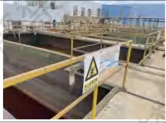
酸性废水处理设施
