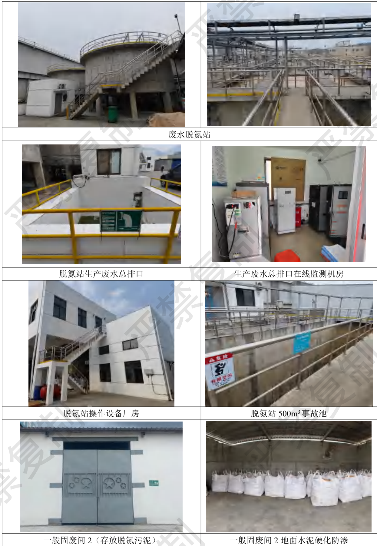
图 3.1-10 上克废水脱氮及配套设施
