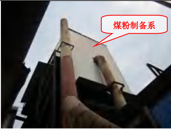
煤粉制备系统
